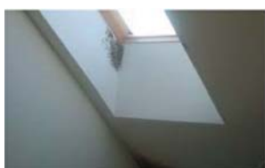
2. ábra. Hibás beépítés következménye
