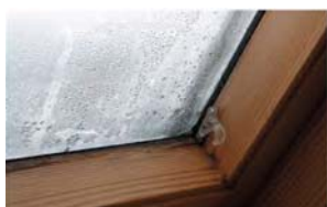
1. ábra. Gyenge minőségű termék beépítésének következménye
