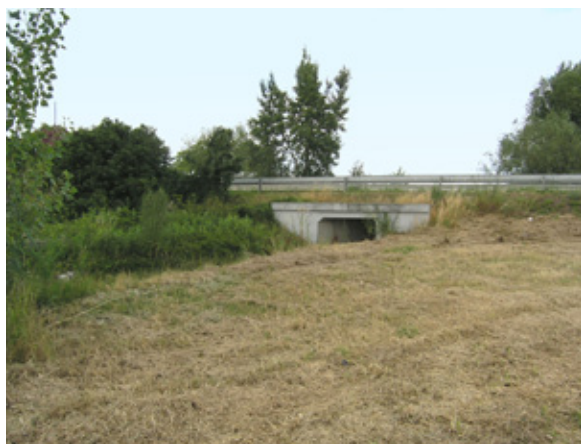
223. Híd a W-X jelű időszakos átfolyásnál
