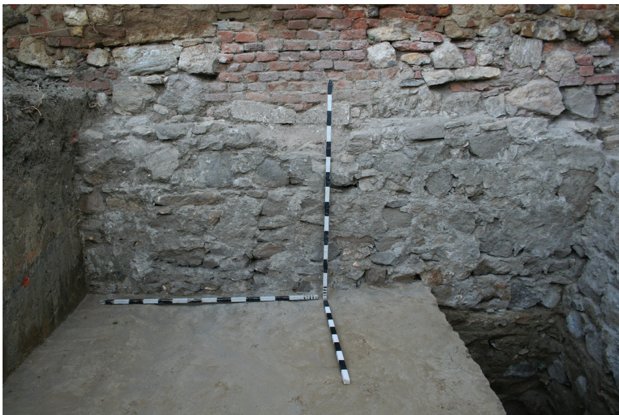
10 – Fundația fațadei principale cu fereastră de pivniță înzidită (SI – profil N)
