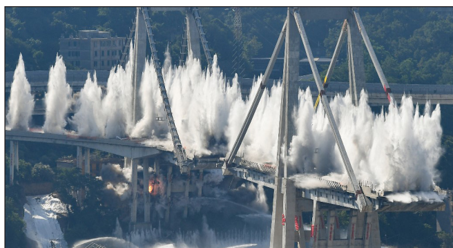
4. ábra: A Morandi-Viadukt vége © Keystone-sda.ch
