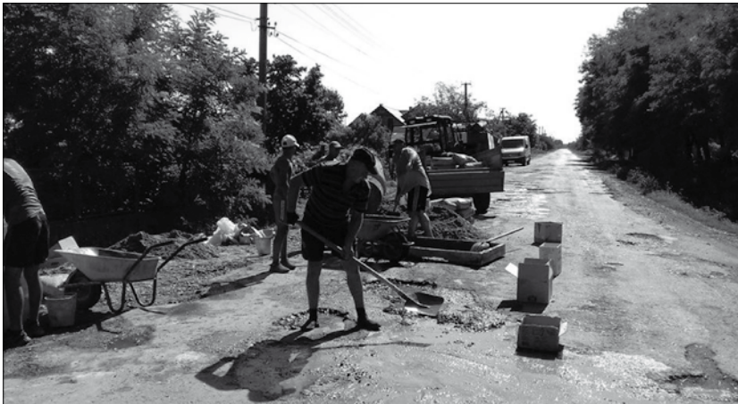
2. kép Nagypalád, 2019. A lakosok a Nagypalád–Fertősalmás közötti közutat javítják (betonozzák). Fotó: Bíró Vencel.
