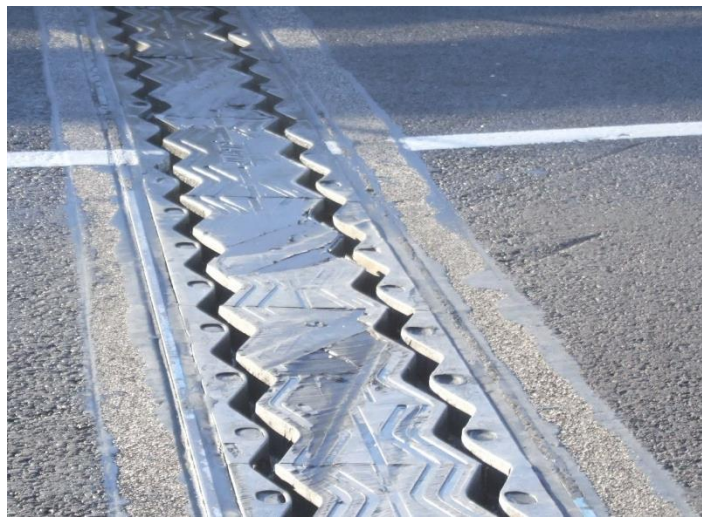
8. ábra: Műgumi dilatáció (és kopóréteg!) mechanikai sérülése hókékezés miatt.
