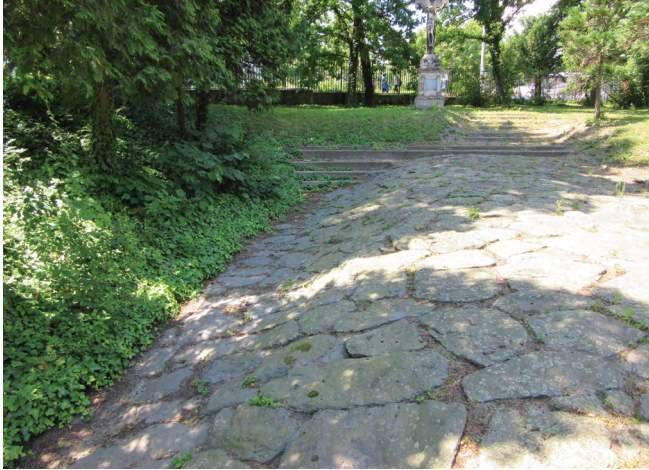
3. ábra. Erőteljesen megsüllyedt római kori útburkolat Savariában. Ilyen mértékű deformációt többnyire földrengés keltette talajfolyósodás okoz. Szombat-hely, Járdányi Paulovics István-romkert. #2156.
