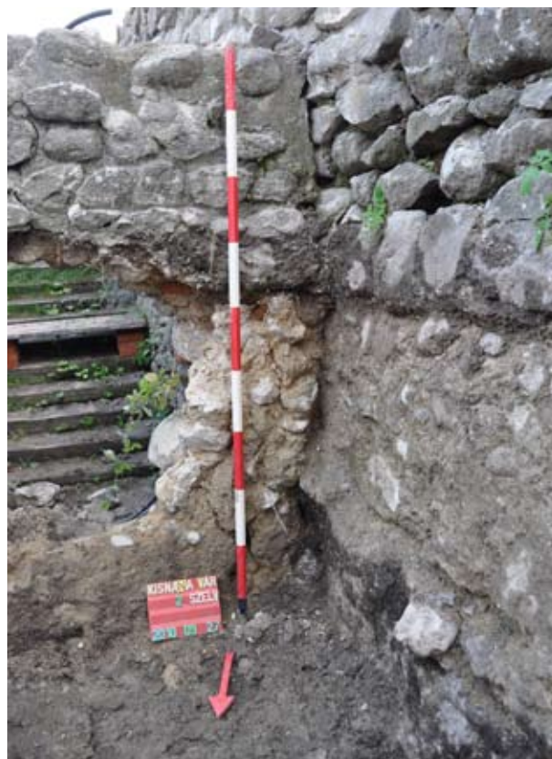
3. A délnyugati épület keleti falának és a pincegádor északi falának elválása a 2010/2. szelvényben
