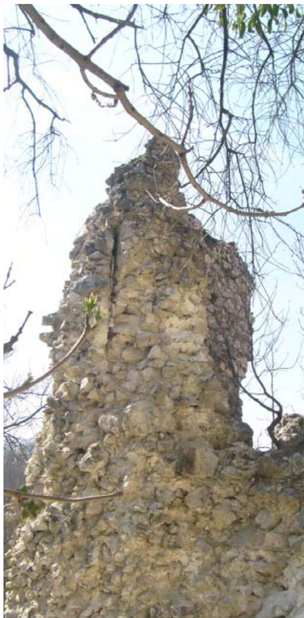
Korábbi alacsonyabb faltető falazott mellvédjének megfigyelhető falelválása a felmegasított délkeleti külső falban
