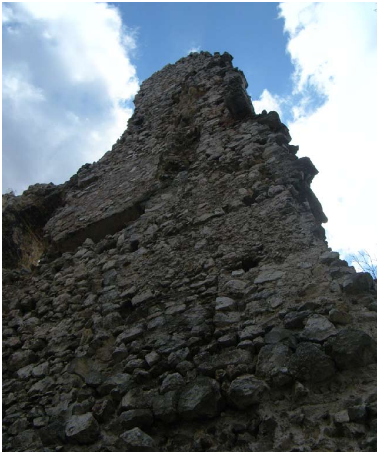
Konzol és falcsorbázat az északnyugati épületrész falán: dokumentálatlan részletek
