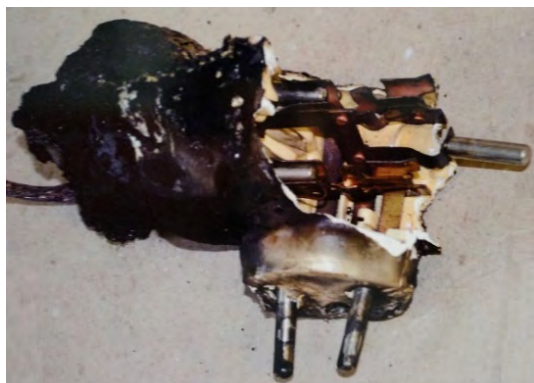
1. ábra. Kontaktkorrózió okozta károsodás villamos csatlakozónál
