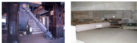
1. ábra. Beépített hidraulikus csillapítók.
