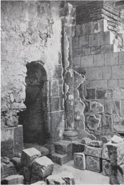
12. Esztergom, III. Béla királyi vára, királyi lakosztály, királyi hálószobájában lévő egyszerűbb illemhely ajtó.
