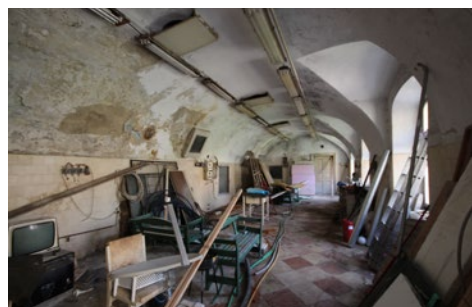
99. Tata, gróf Esterházy kastély barokk konyhaterme felújítás előtt, baloldalt közepén a tűztér kéménynyílása, mint szellőző, de még látszik
