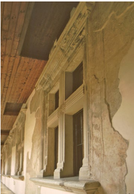
34. Kőszeg, királyi várkastély, Mátyás király lakosztály királyi ebédlője két restaurált négyosztatú reneszánsz ablaka.
