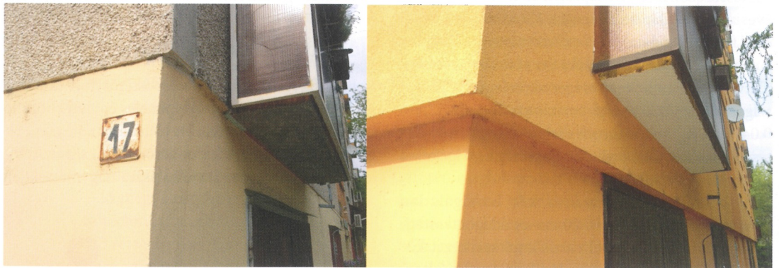
2. ábra: A garázsajtó felső síkjától induló homlokzati hőszigetelés. Az erkély azonban hőszigetetlen
