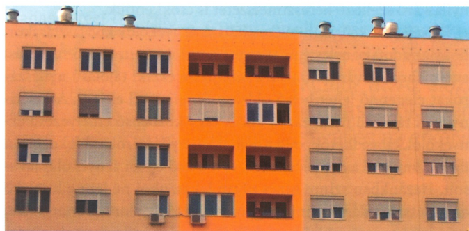
2. ábra: Felújított panelépület, néhol beépített erkélyek és kültéri klímaegységek elhelyezésének hatása a homlokzati képre
