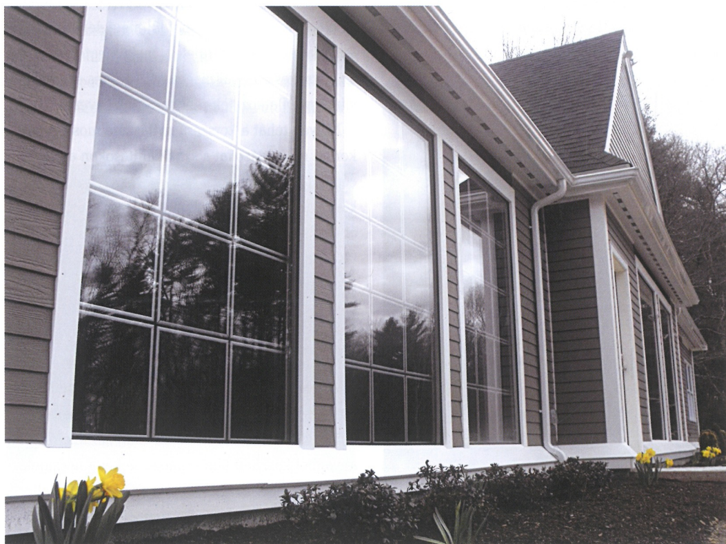
5. ábra. Energiagyűjtő fal egy Middleborough-i (MA, USA), közel zéró energiaigényű családi házon
