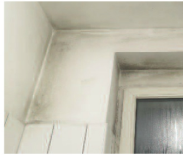
4. ábra – Kialakult penész a párale-csapódással sújtott hőhidas épület-szerkezeteken
