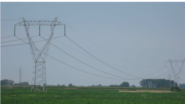
Slika 1: Nadzemni vod naponskog nivoa 400 kV
