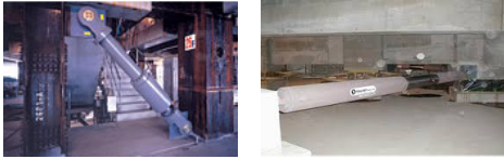
1. ábra. Beépített hidraulikus csillapítók.
