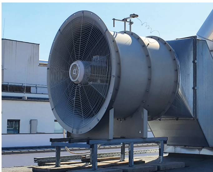
2. ábra: A lépcsőház füstmentesítő ventilátora a zárófödemen
