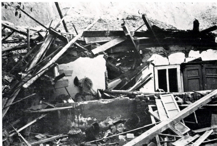
9—10. kép. Földesuszamlás szakadásfrontja mentén kettévált ház Dunaföldváron House split into two by the main scarp of slide at Dunaföldvár
