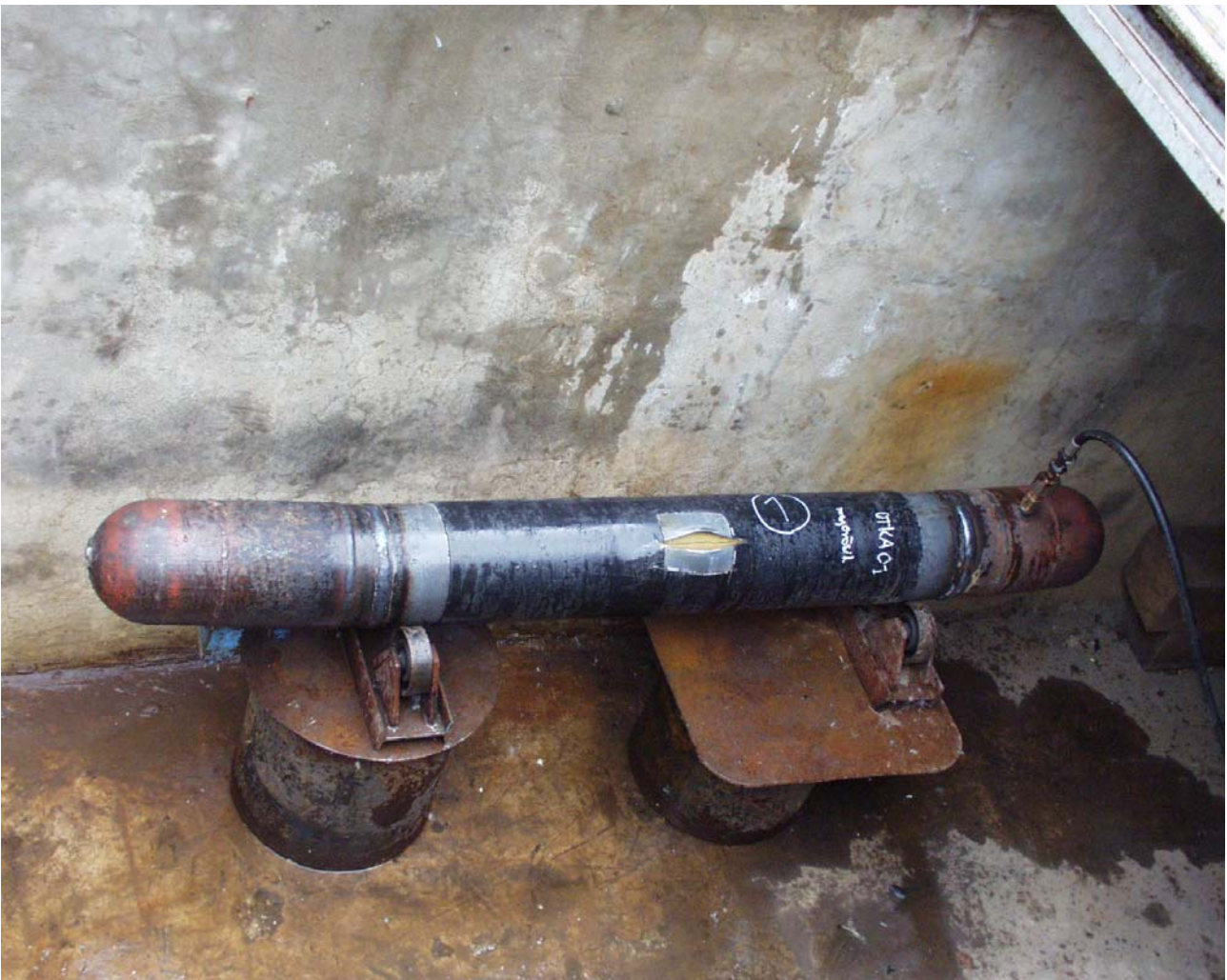
53. ábra. A belülről megerősített, mesterséges hibát tartalmazó, DN 200-as csőszakasz (o1) a károsodást követően.
