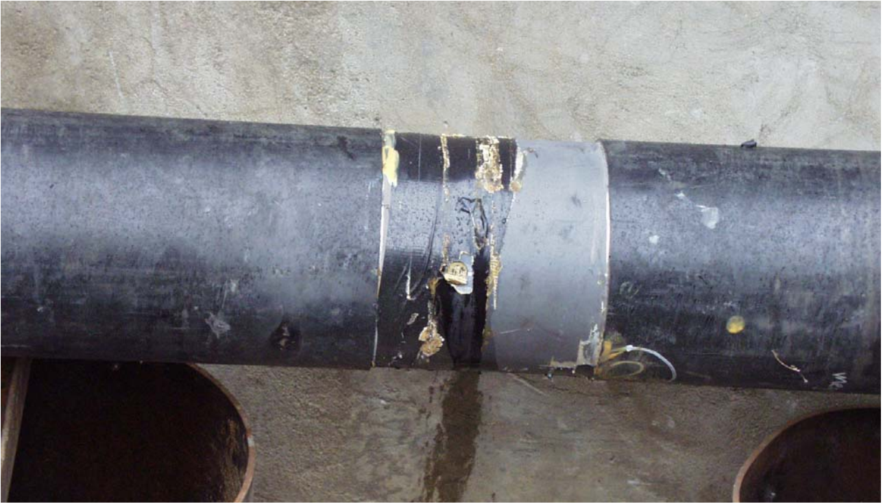
48. ábra. A belülről megerősített, mesterséges hibákat tartalmazó, DN 200-as csőszakasz (o2) a teljes károsodást követően.
