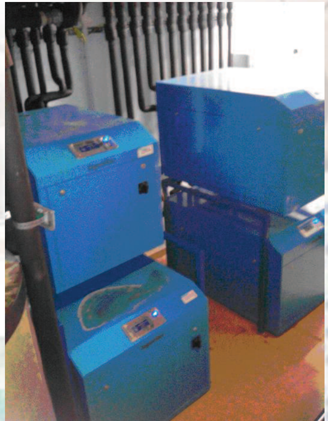
4. ábra: Magyar hőszivattyúk (egymás fölé telepítve 2 x 2 = 4 db) a nagykőrösi fürdő hőközpontjában Fotó: Spring Projekt Kft. (Ecser Róbert)
