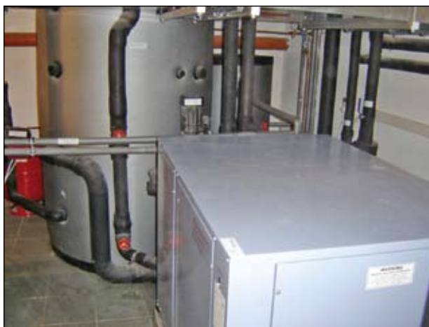
6. kép: ATIKÖFE szegedi irodaház hőszivattyús hőközpontja
