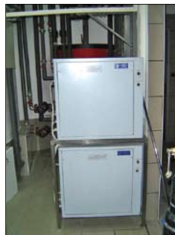
10. kép: Sátoraljaújhelyi Betegellátási és Prevenció Központ hőszivattyús hőközpontja
