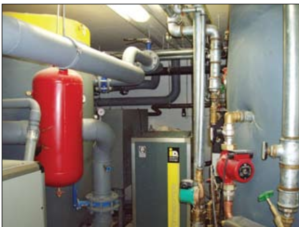
8. kép: Budapesti 88 lakásos társasház hőszivattyús hőközpontja
