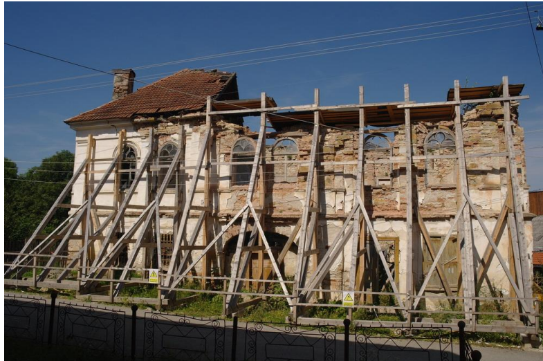
2. kép Leromlott állapotú bányászházak Verespatakon
