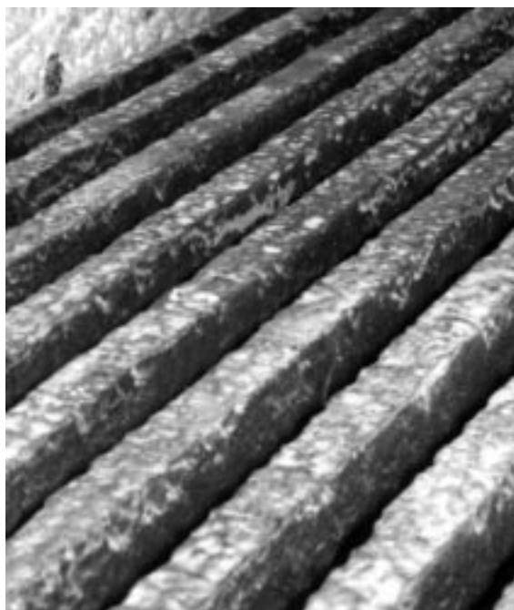
4. ábra. A Lánchíd erősen korrodált, homokfúvással letisztított lánclemezei a lánckamrában
