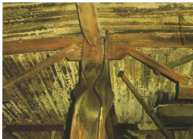
BROADGATE: HORPADT OSZLOP, DEFORMÁLÓDOTT GERENDA
