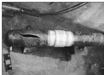
27. ábra: Külsőleg erősített csőszakasz a repezítés után
