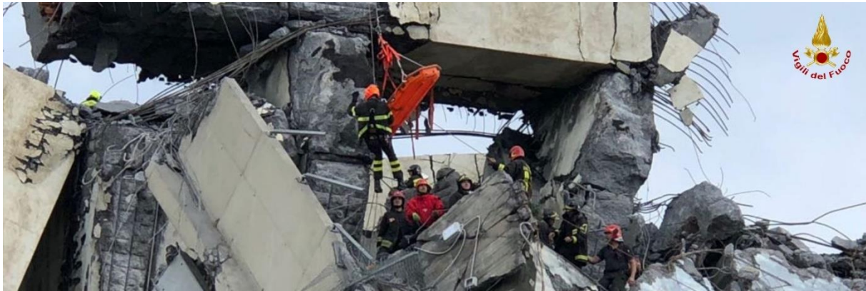
16. ábra Genovai hídomlás során a tűzoltó egységek kötéltechnikai mentéssel végzik a bajbajutott áldozatok magasban történő kiemelését 2018. augusztus 17-én. 27
