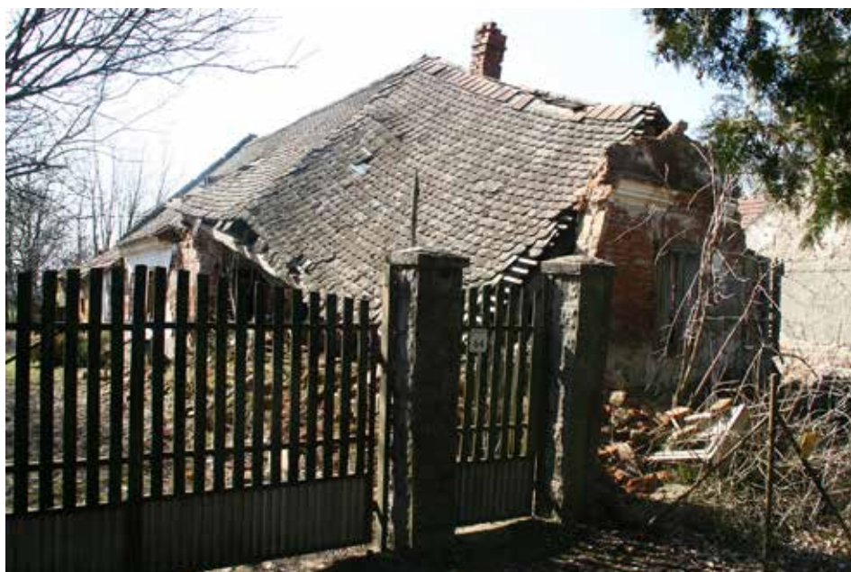
4. ábra. Összedőlt parasztház Zsebeháza faluban
