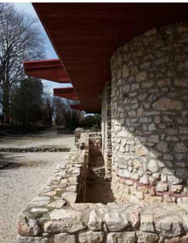
6. kép Jelentős mértékű és tömegességu felfalazások az apszisoknál és konzolos tető
