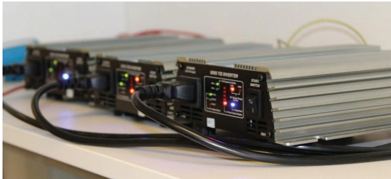
9.3. Ábra: Fotovoltaikus modulok egyfázisú rácsatlakozója. Forrás: A szerzők fotója
