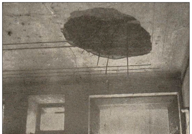
6. ábra: A Mátrai fődém kagylós leszakadása
