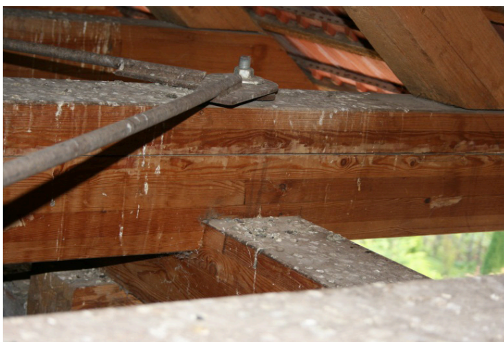
2. ábra A kisharsányi templom tetőszerkezetének repedése az erőbevezetésnél
