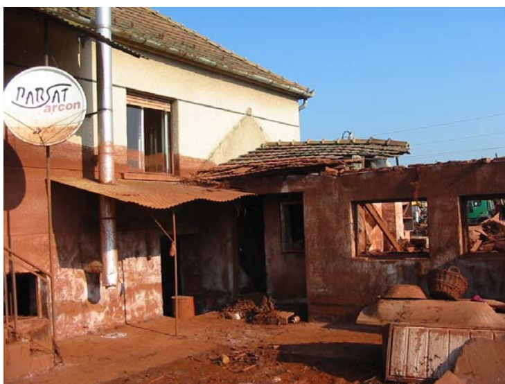
A vörösiszap-katasztrófában károsodott épület Devecseren
