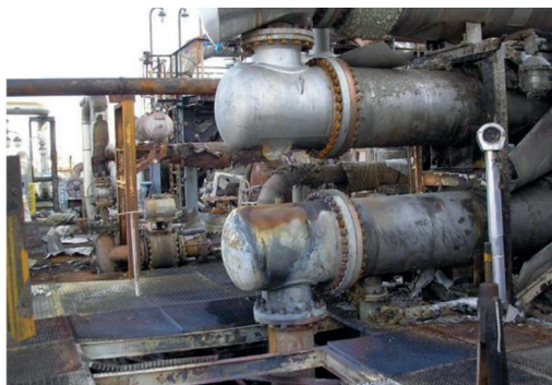
2. fénykép – A károsodások mértéke az érintett létesítményben [11]
