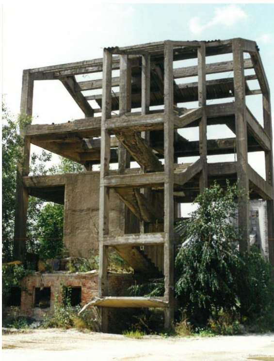
2. számú ábra. Az egykori előosztályozó vasbeton szerkezete a lépcsőház mögött, +2,8 m fölött elhelyezkedő zárt tartállyal 10
