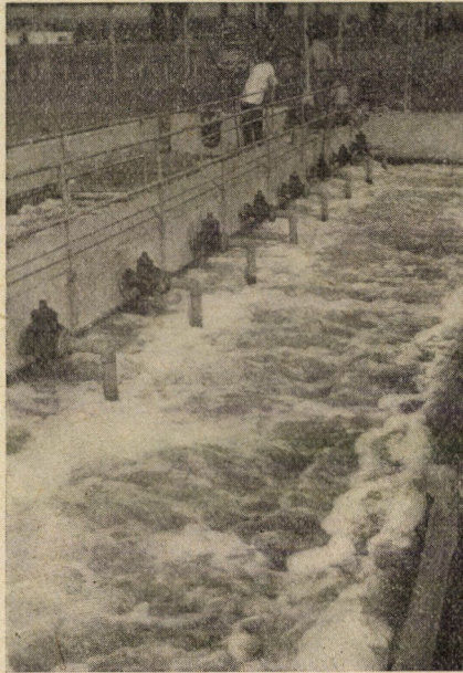
6. ábra. A hatvani légbefúvásos levegőztető medence üzem közben. A kép hátsó részén látható elkerített térrészben az oxigénfelvételi vizsgálat történik
