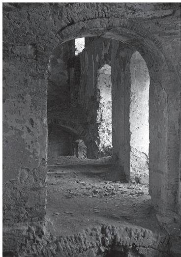
Fig. 60. Ziduri și bolți prăbușite în interiorul aripii principale a castelului în anii 1990, Kalló Angéla.
