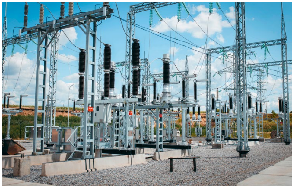
2. ábra. Villamosenergia-rendszer átviteli hálózati alállomása. Forrás: Adobe Stock 523500924
