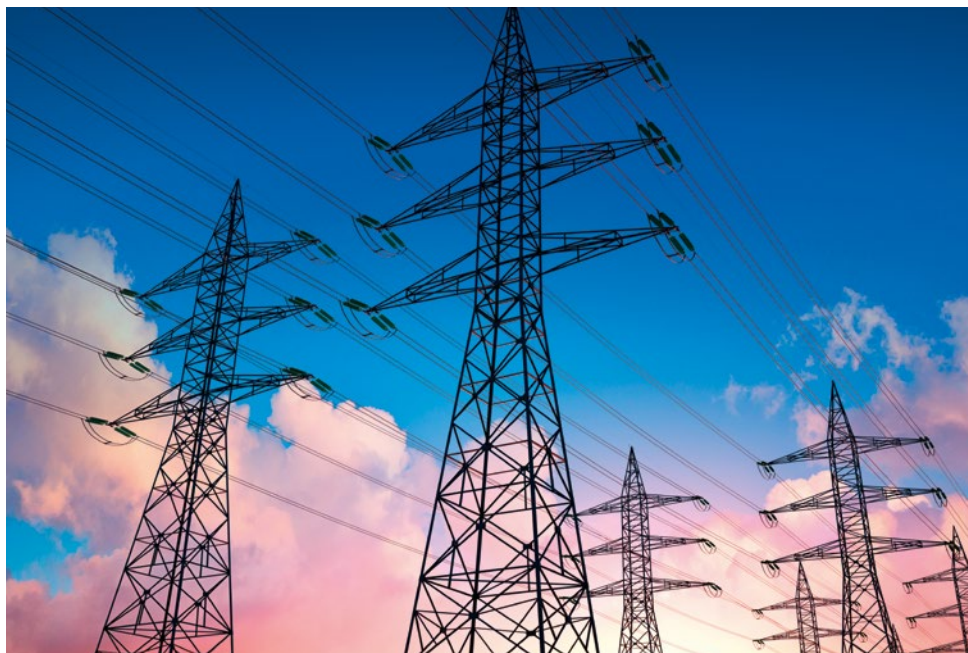
1. ábra. Nagyfeszültségű távvezetékek az átviteli hálózatban. Forrás: Adobe Stock 440725469.
