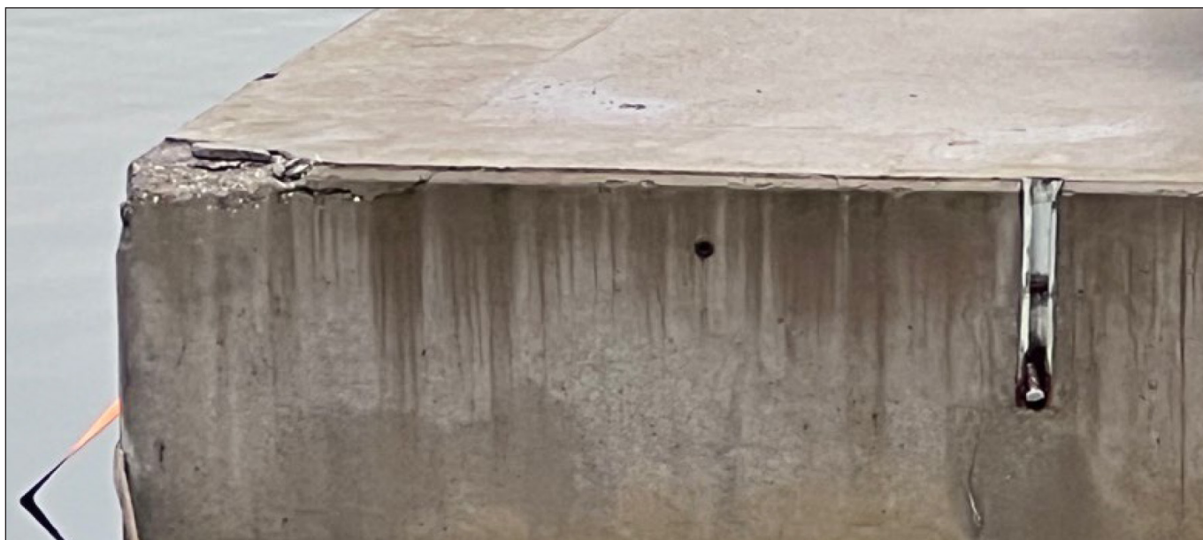
12. ábra: Felületi repedések 1
