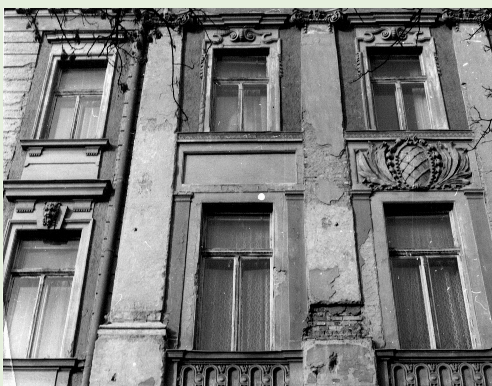
A homlokzat állapotáról készült felmérési fénykép részlete az 1980-as évekből. (OBH Műszaki Főosztály Irattára)
