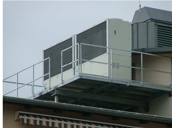
2. kép: A hévizi 2 db 56 kW hűtési teljesítményű földgáz motoros klímaberendezés közeli fotója Forrás: Regale Klímatechnika Kft.
