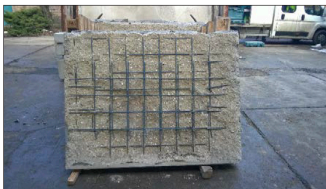
4. ábra: Az alsó falpanel elem károsodása a tűz után
